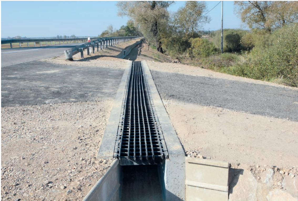
Stopryna chroniąca płazy przed wejściem na jezdnię z bocznych dróg
