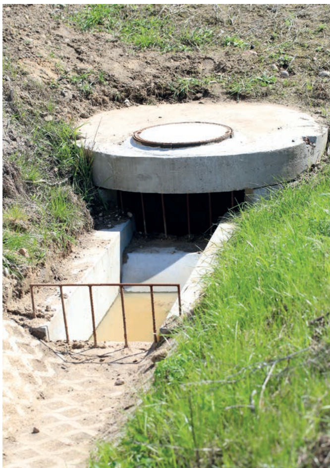
Studzienka ściekowa z wpustem i osadnikiem stanowi śmiertelną pułapkę dla płazów
