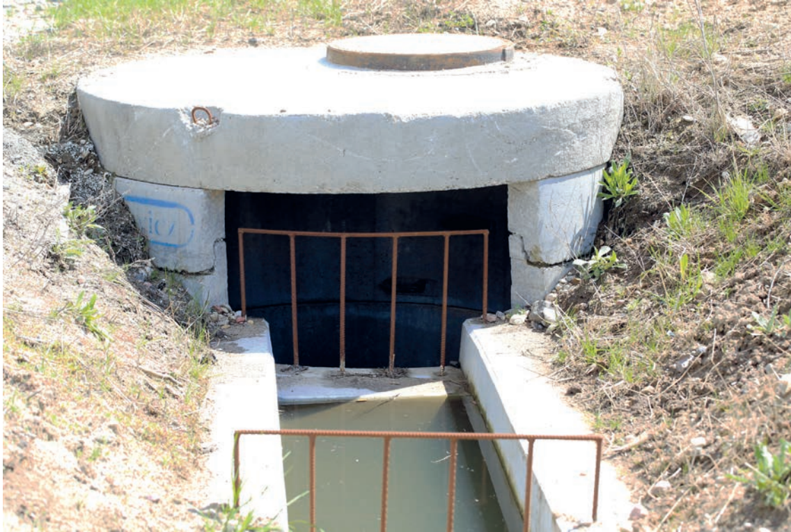
Studzienka ściekowa z osadnikiem stanowi śmiertelną pułapkę dla płazów
